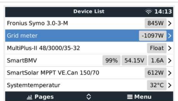
Oder so konfiguriert, dass der Energieverbrauch aus dem Netz gemessen wird
